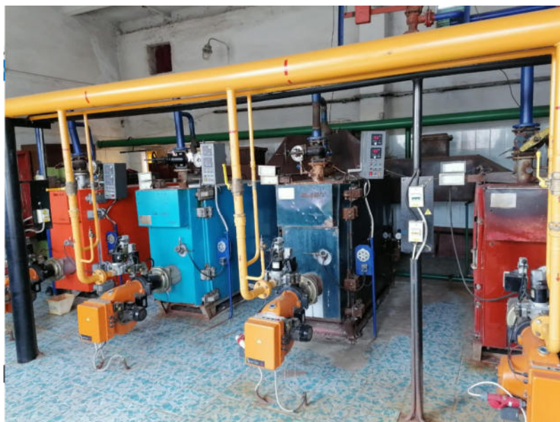
Рис. 6 Водогрейные Котлы КВа-0,63Гн, установленные в Котельной № 3 г.Калач-на-Дону
